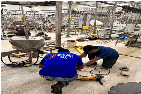
Mantenimiento de equipo industrial
